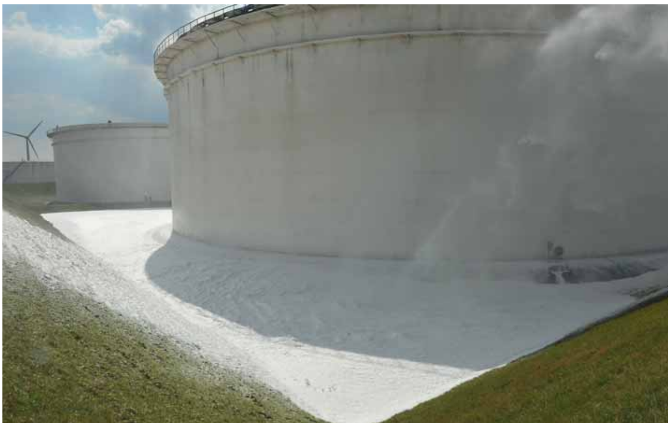
Schuim in een tankput.
